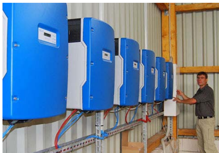
Die Photovoltaik der Halle versorgt 10 Haushalte.
